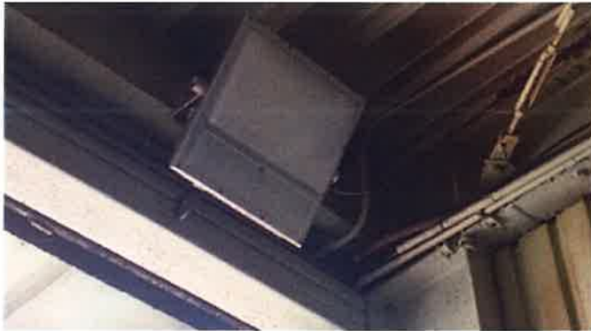
工場内照明のLED化
